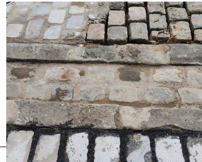
Rigole en surverse entre les noues / caniveau
