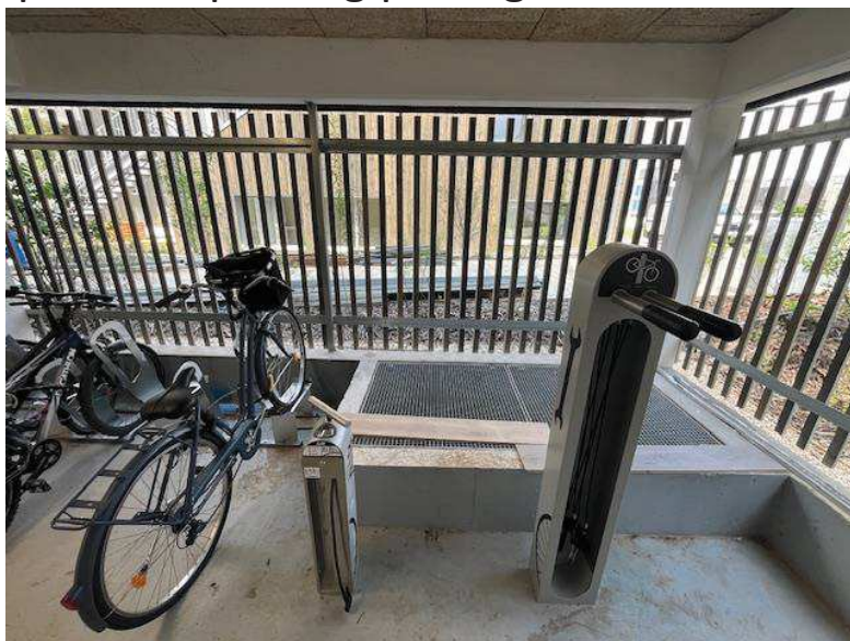
Borne de réparation installée dans le lot C1-C2
