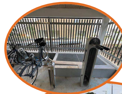
Exemple de borne de réparation installée dans le lot C1-C2
